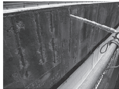
写真-1 壁高欄変状状況
