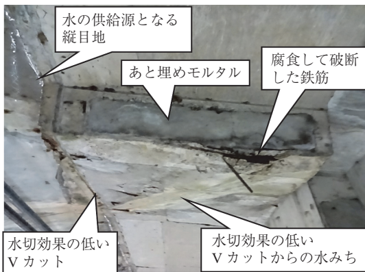
写真 - 3 定着部変状状況
