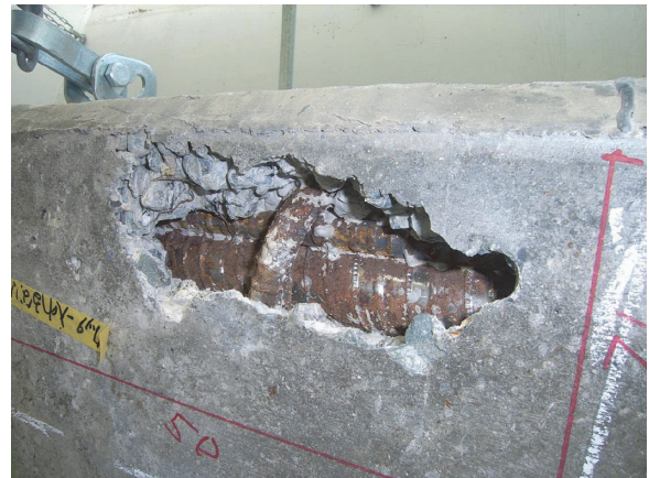
写真 - 5 主桁下縁空隙状況
