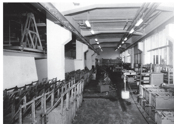
写真 - 4 緊張機器の整備室 （手前には水圧ポンプが所狭しと並び立てられている）
