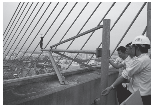
写真 - 4 主塔水平梁に設置された風速計
