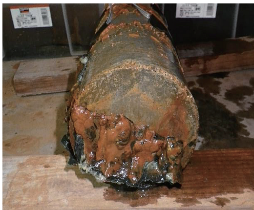
写真 - 1 腐食生成物の流出（腐食減量率：約 35%）
