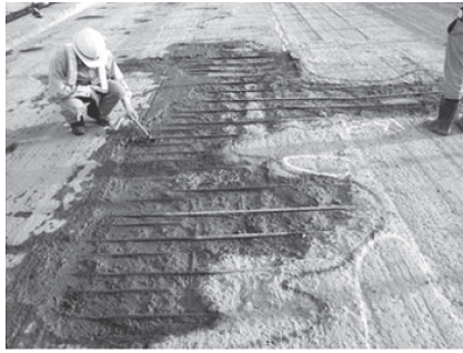
写真 - 1 RC床版上面の土砂化
