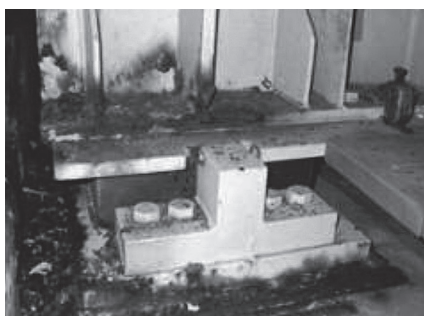
写真 - 7 桁端部付近の腐食
