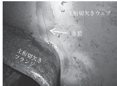
写真 - 5 桁端切欠き部に発生する疲労き裂
