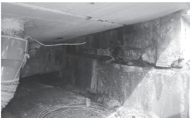
写真 - 2 桁端部劣化損傷状況
