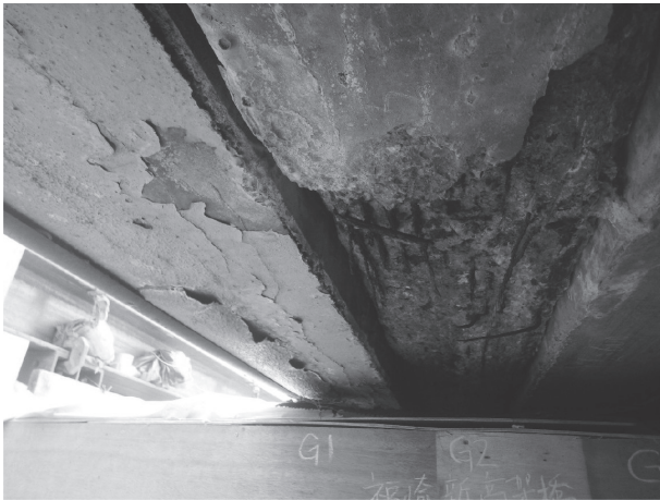
写真 - 1 桁下劣化損傷状況
