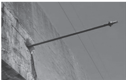
写真 - 7 PC 鋼棒の破断飛び出し
