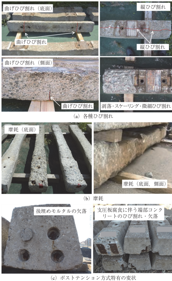
図 - 1 PC まくらぎに生じる主な変状の例
