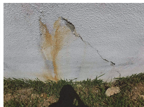
写真 - 2 漏水箇所
