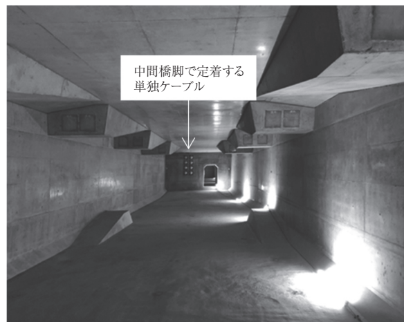
写真 - 1 PCケーブルの定着状況
