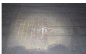
写真 - 2 箱桁ウェブ変状 (遊離石灰)
