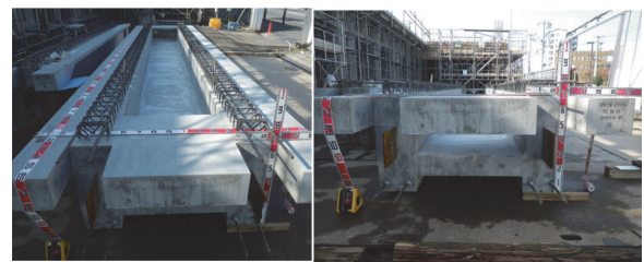
写真 - 4 床下配管スペース付き DT 版
