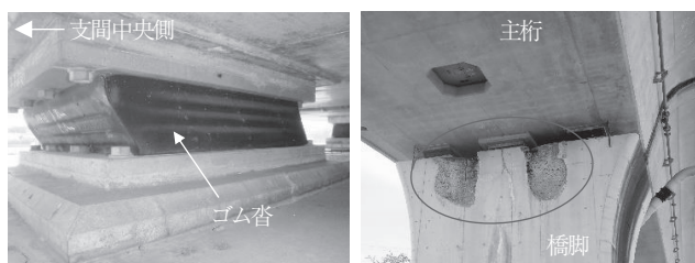
(a) 支承の変形
