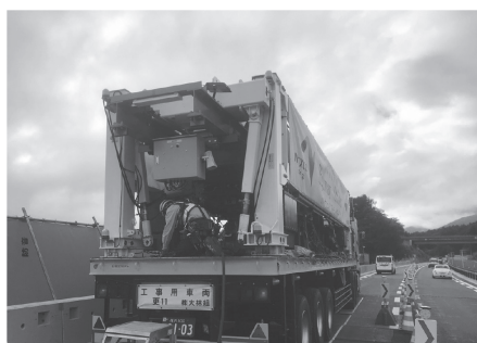
写真 - 8 移動式門型揚重機格納時
