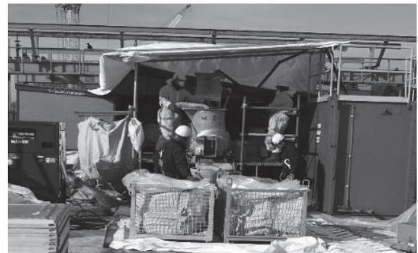
写真 - 3 プラント全景
