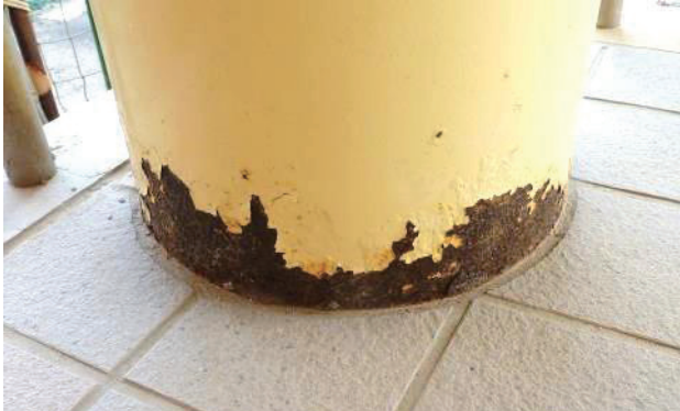
写真 - 1 震災後約4年で腐食が顕在化した学校施設 (2014年12月 筆者撮影)
