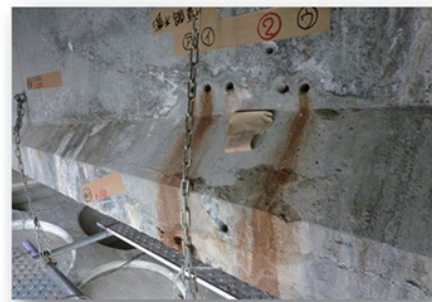
シースに沿ったひび割れ、さび汁
