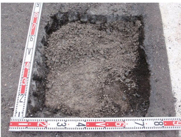
写真 - 2 コンクリート床版の砂利化の事例 (著者撮影)
