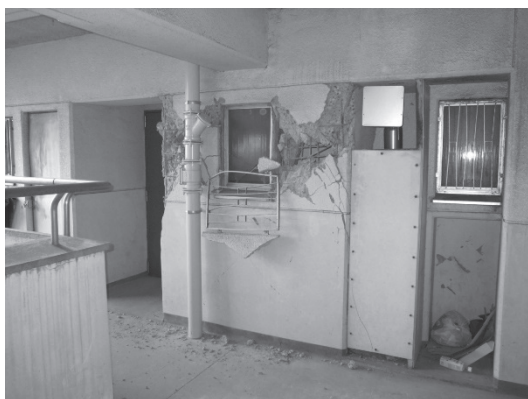
写真 - 1 RC造集合住宅の非構造壁のせん断破壊
