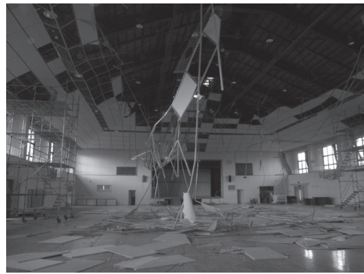
写真 - 2 落下した体育館の天井
