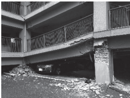
写真-5 層崩壊したピロティを有するRC造集合住宅
