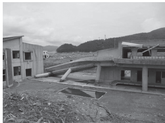
写真 - 4 津波で倒壊したRC構造物
