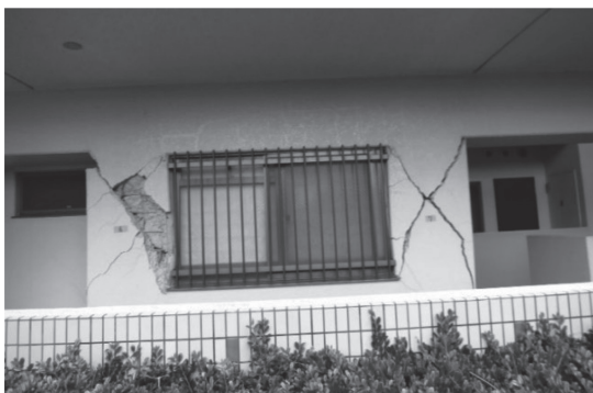
写真-6 集合住宅のRC造2次壁の被害
