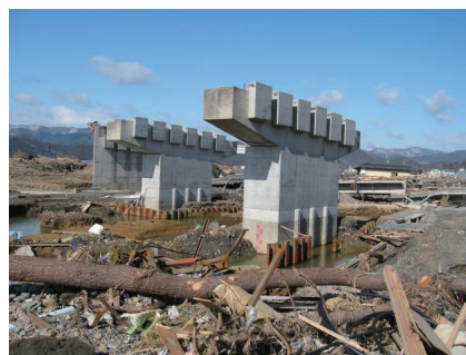
(a) 津波による上部構造の流失被害（東日本大震災）
