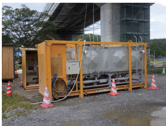
写真 - 13 熱分配方式パイプクーリングシステム
