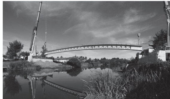
図 - 1 プレキャンバー桁の架設状況（South Razor Clam 橋）※前編に掲載されている図を引用
